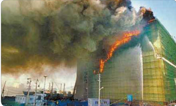
부산 냉동창고 신축공사 화재('98.10.29 사망27, 부상 16)
